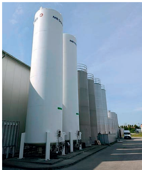
Fot. 4. Zbiorniki z azotem
