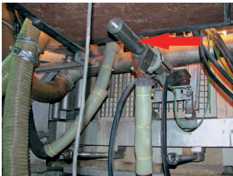
Fot. 2-3. Miejsce pracy poszkodowanego, strzałką zaznaczono elektrodę, na której leżał
