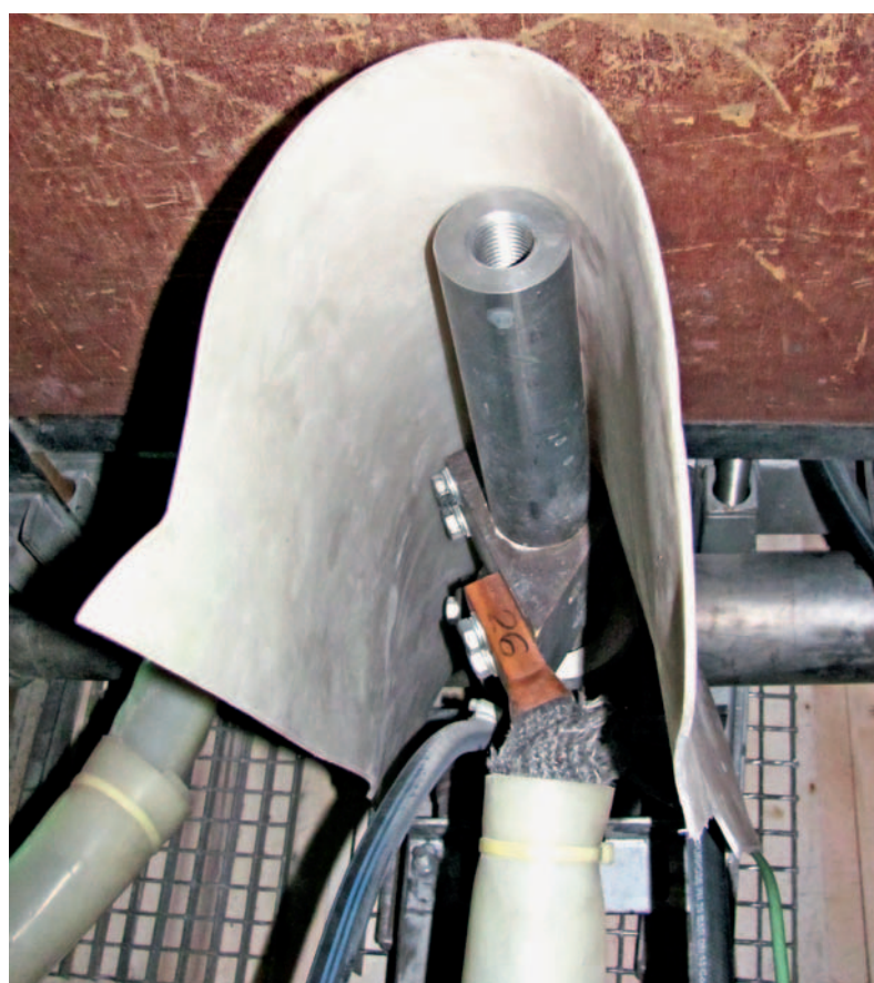
Fot. 5-6. Elektroda z nałożoną matą. Widoczny brak możliwości mocowania
