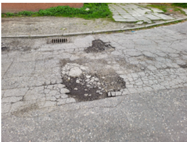
Fot. 2. Zniszczenia powierzchniowe warstwy ścieralnej
