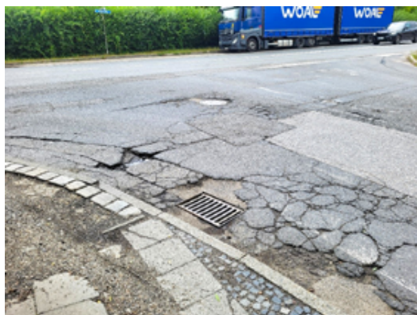
Fot. 1. Nawierzchnia drogi zniszczona przez samochody ciężarowe
