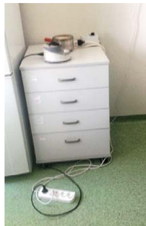
Za mało gniazd elektrycznych
