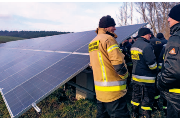
Fot. 2. Instalacja fotowoltaiczna naziemna
