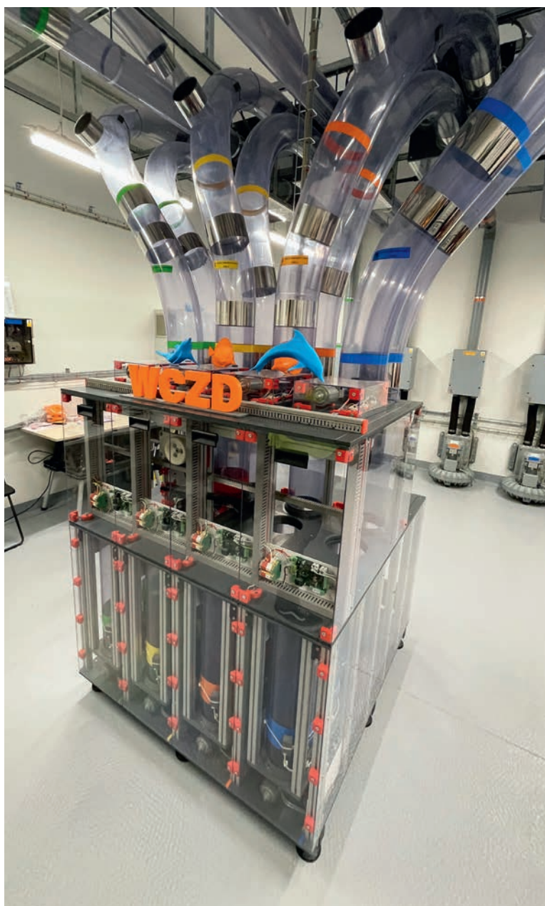
Ryc. 2. Maszynownia poczty pneumatycznej w Wielkopolskim Centrum Pediatrii w Poznaniu. Zdj. Piotr Springer
